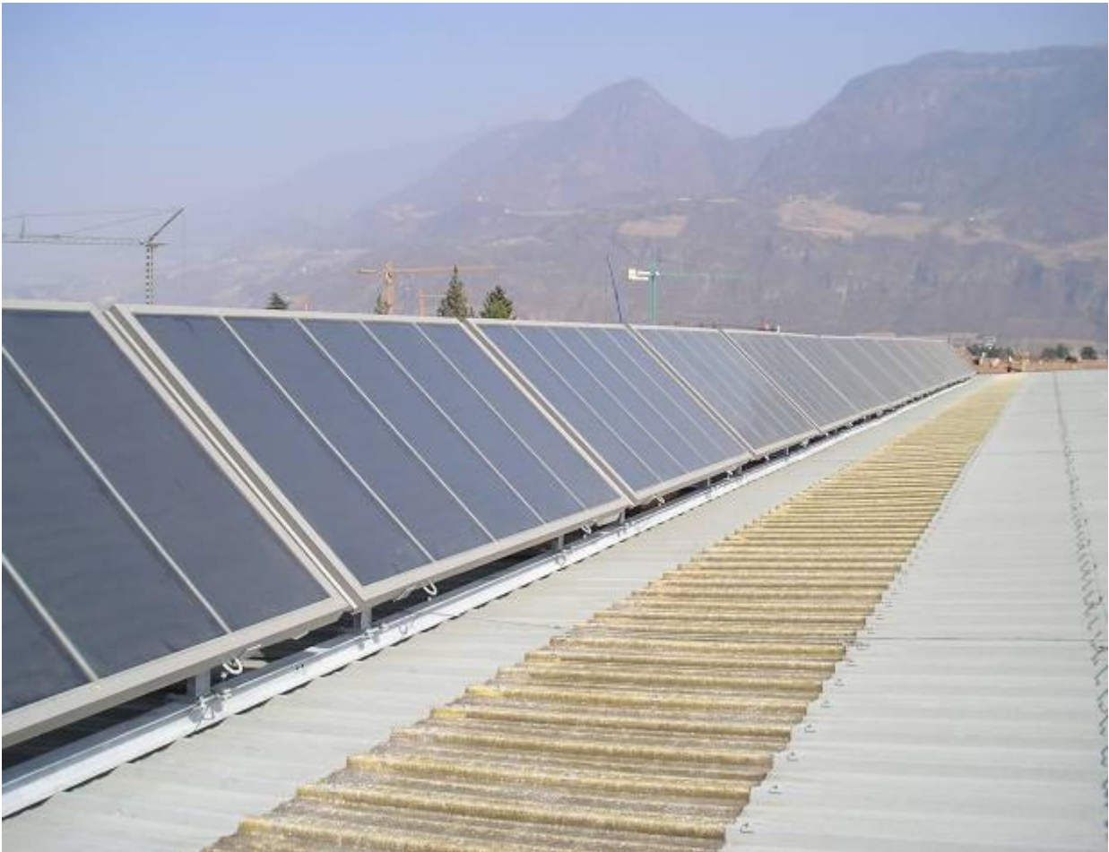
LANA (BZ) - IMPIANTO DA 230 MQ DI PANNELLI SOLARI AUTOCOSTRUITI
