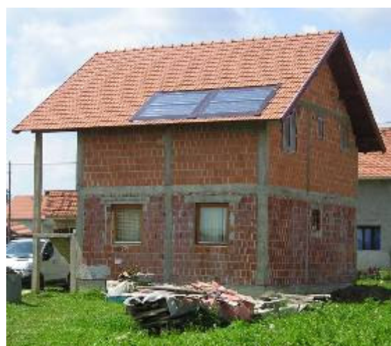
I PANNELLI INSTALLATI SULLA CASA PRIVATA
